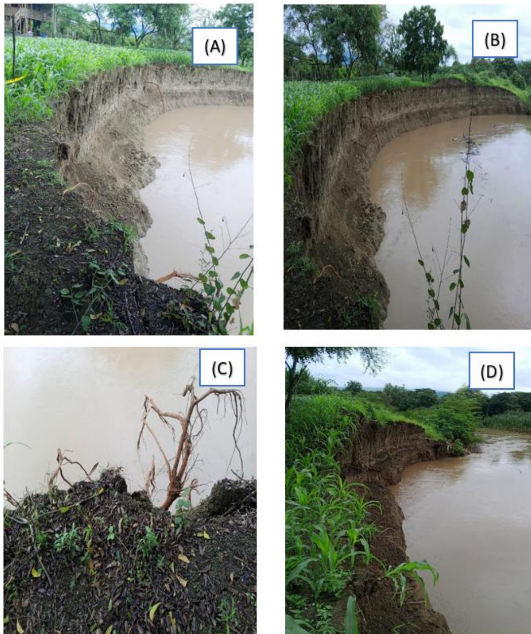
Figura 3. Fotografías de la desestabilización y socavación hídrica en el talud del cauce del río Portoviejo, sector Picoazá
